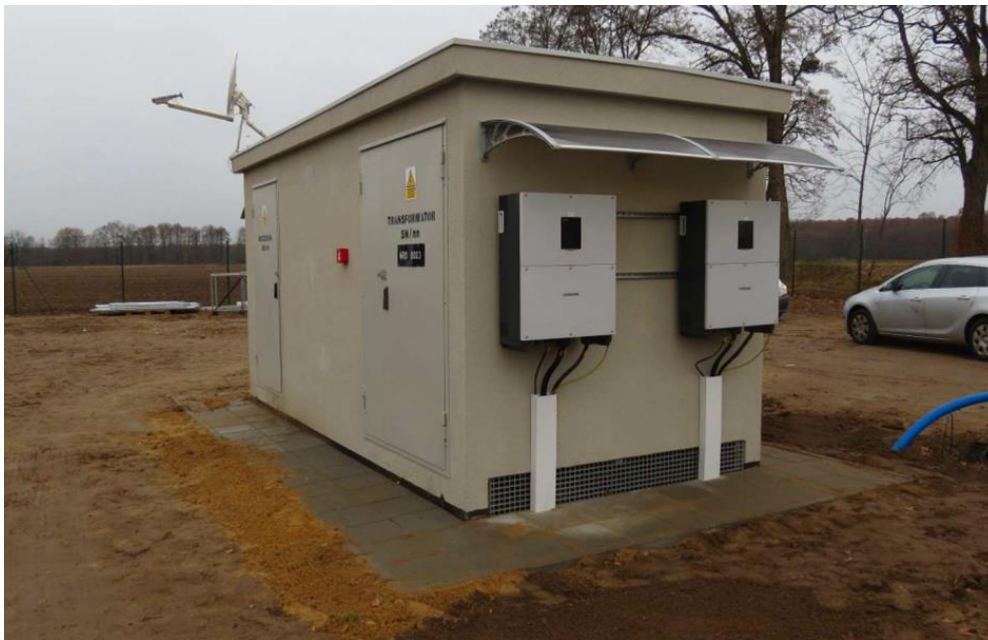
Ryc. 21 Przykładowa stacja transformatorowa z zainstalowanymi falownikami.
