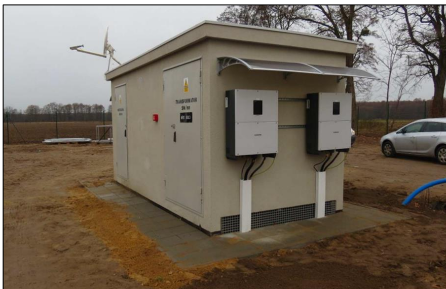
Ryc. 18 Przykładowa stacja transformatorowa. Źródło: materiały własne.
