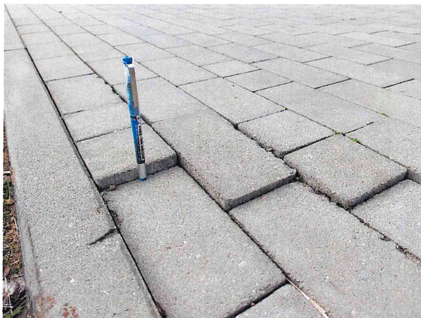
Zdjęcie nr 65. Uszkodzona nawierzchnia z kostki betonowej szarej, bezfazowej.
