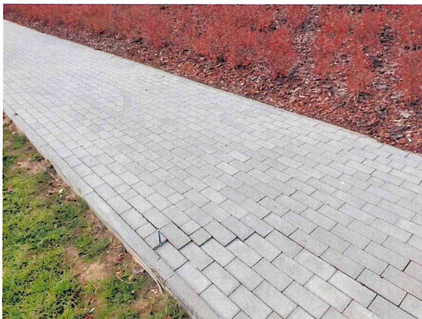
Zdjęcie nr 66. Uszkodzona nawierzchnia.
