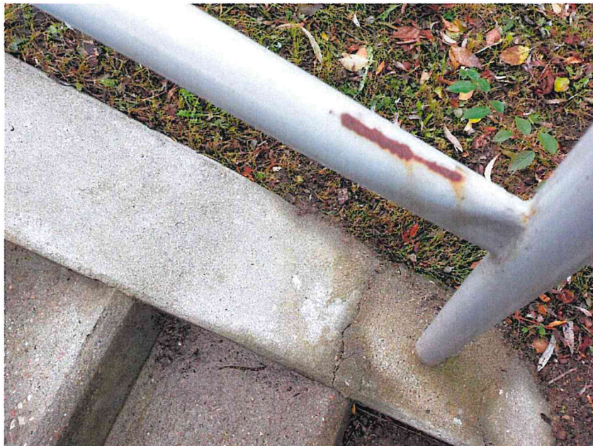
Zdjęcie nr 72. Ubytki w powłoce malarskiej na balustradzie stalowej na schodach skarpowych.
