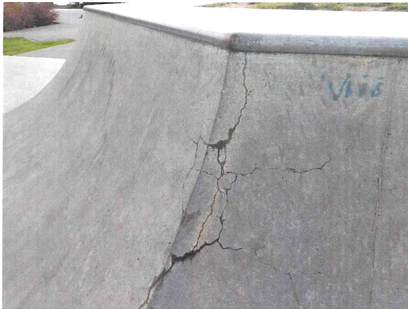
Zdjęcie nr 13. Pochylnia/tor skate parku, spękania betonu.
