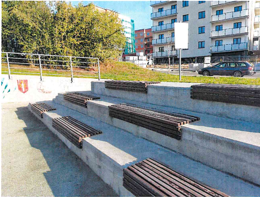
Zdjęcie nr 5. Siedziska drewniane – zużyta impregnacja elementów drewnianych.
