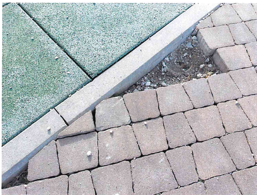
Zdjęcie nr 29. Ubytki w nawierzchni z kostki betonowej.
