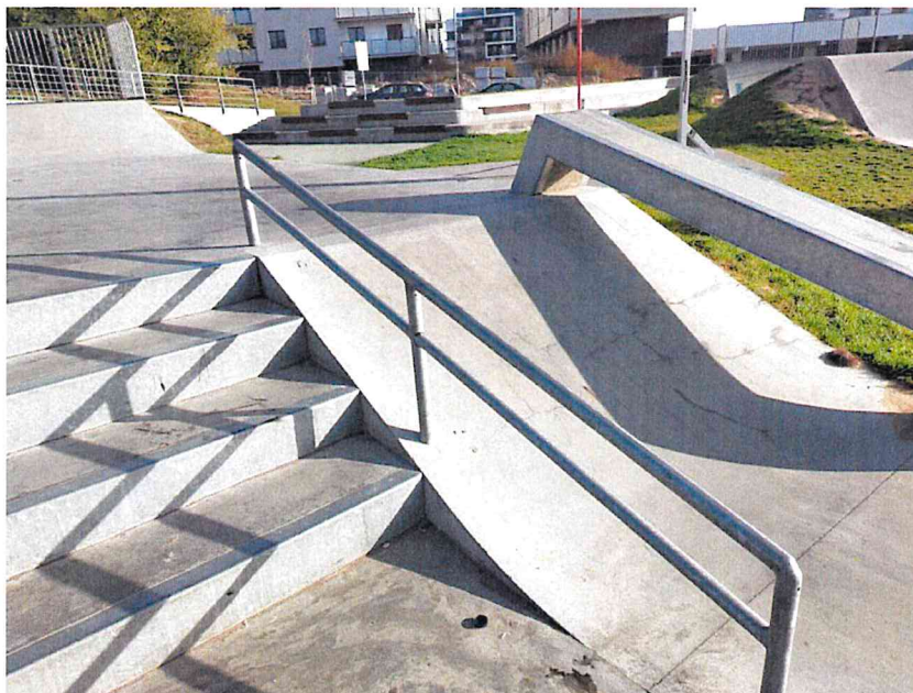
Zdjęcie nr 12. Schody i pochylnia skate parku, spękania betonu na pochylni.
