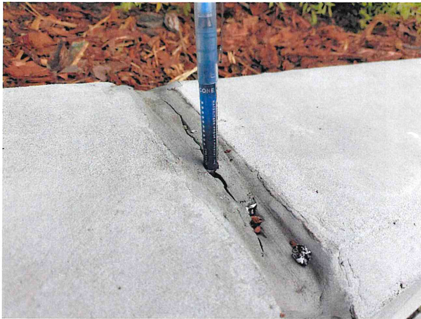
Zdjęcie nr 55. Uszkodzone uszczelnienie szczeliny dylatacyjnej, murek oporowy.
