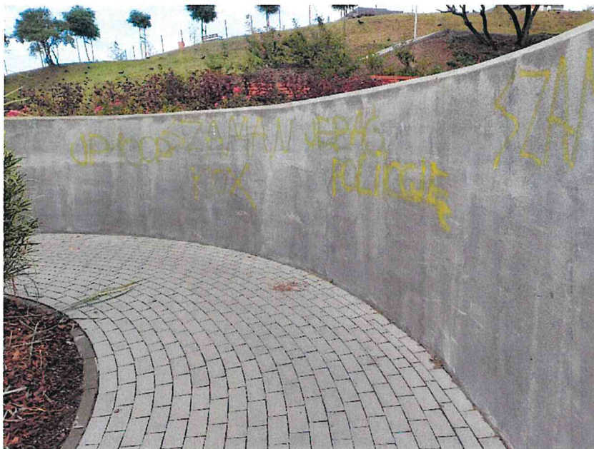
Zdjęcie nr 73. Akt wandalizmu na murku oporowym.
