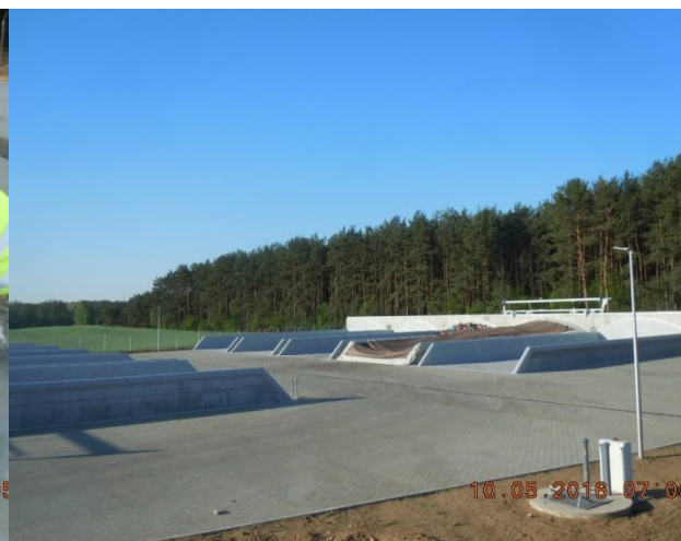
Rysunek 32 Tak jest. Nowa instalacja do biologicznego przetwarzania odpadów z możliwością kompostowania odpadów zielonych, Puszcza Miejska (foto: Puszcza Miejska, marzec 2016r).
