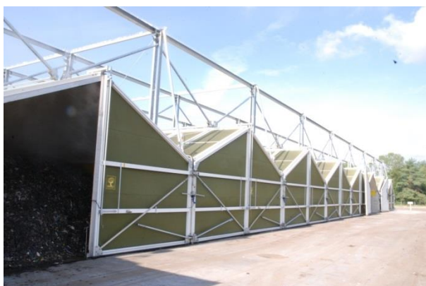
Rysunek 72 Tak było i jest. Instalacja stabilizacji frakcji biodegradowalnej wydzielonej ze zmieszanych odpadów komunalnych, Toruń MPO (sierpień 2013r)
