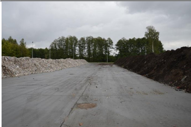
Rysunek 11 Tak jest. Nowa kompostownia polowa odpadów zielonych oraz plac dojrzwiania stabilizatu, Sulnówko (foto: Sulnówko, wrzesień 2015r).
