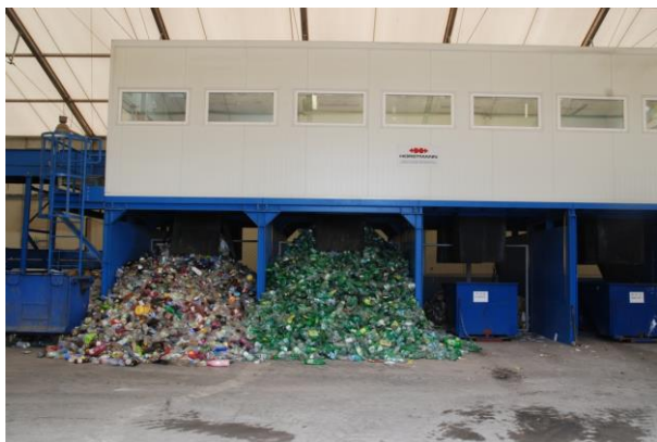
Rysunek 19 Tak było. Sortownia odpadów komunalnych, Osnowo – kabiny sortownicze (sierpień 2013r)
