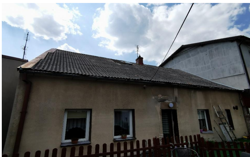
Rys. 3. Budynek mieszkalny pokryty płytą falistą azbestowo-cementową zlokalizowany w Gminie Świecie (źródło: własne).
